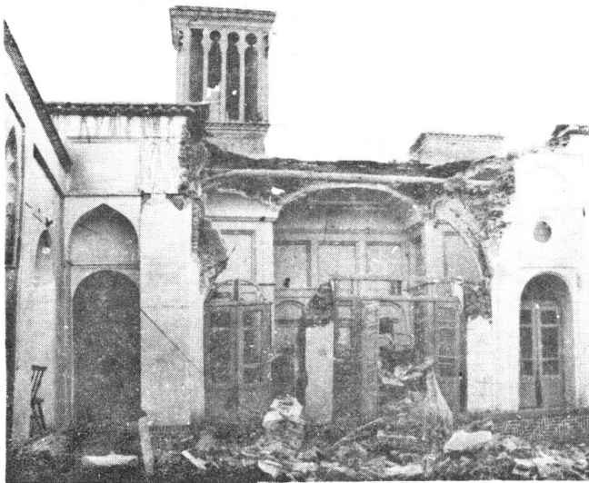
کرمان - خانه قدیمی لطفعلی زاده فدائی و آسیب وارده بآن بر اثر زلزله و سقوط یکی از بادگیرها بر روی سقف
